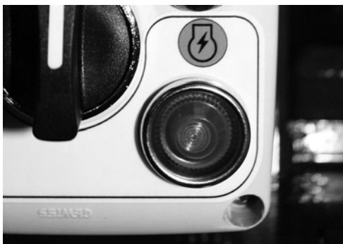
Fig. 136 Notfallbedienpult Kontrolllampe Freigabe Hubteil
